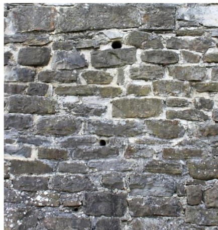
Slika 4.11. Cijevi za odvod vode
