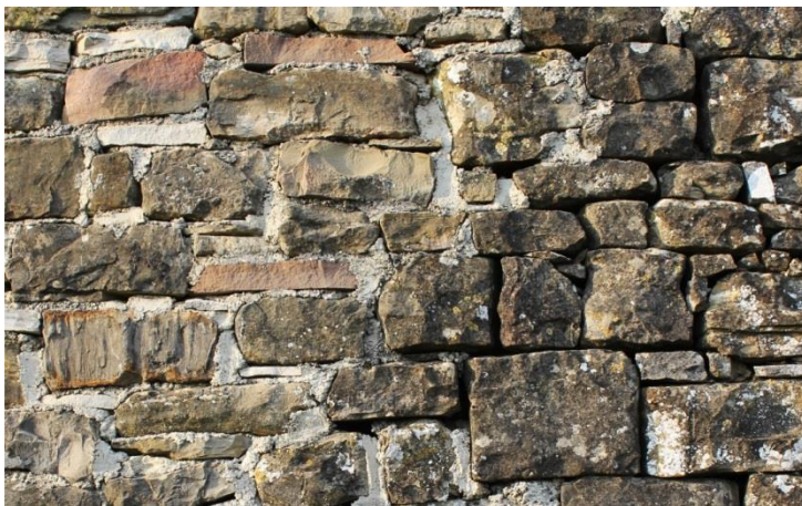
Slika 4.10. Dio zidina koji je „obnovljen“ betonom
