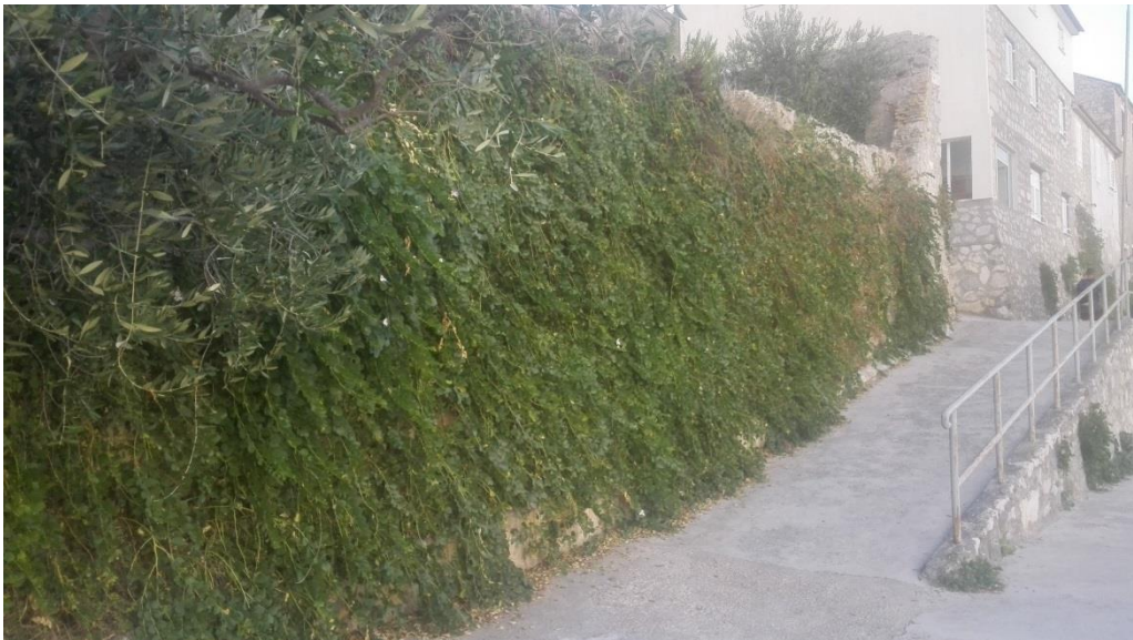
Slika 3. Samonikle biljke kapare na zidu (foto: K. Bajlo)
