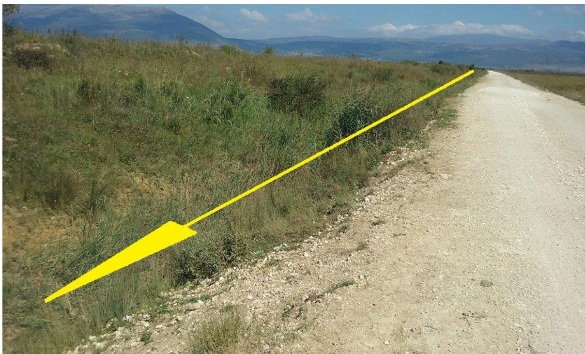
Slika 9.: Loše stanje kanala II reda
