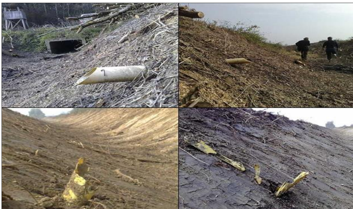
Slika 16. Prikaz oštećenja cijevne drenaže u postupku obnove melioracijskih kanala II i IV reda (AFZ, 2015)
