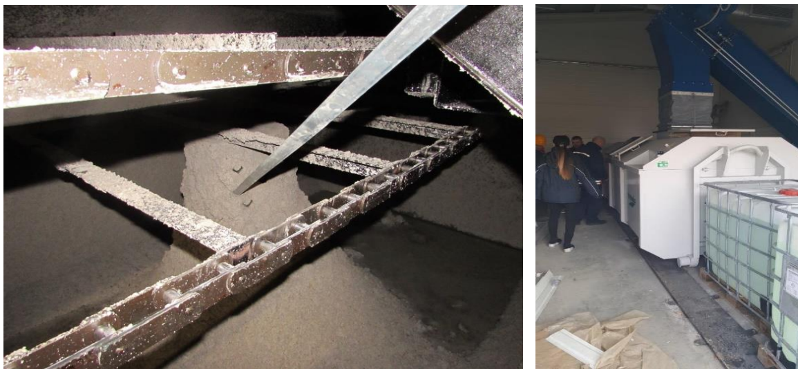
Slika 3.3. Prikaz pepela sa dna ložišta (lijevo) i lebdećeg pepela (desno) pohranjenog u posebnom spremniku
