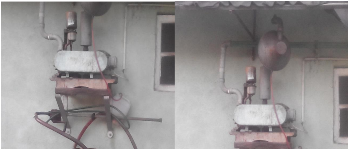
Slika 13. Podtlačna pumpa i filter zraka (Foto: Švub)
