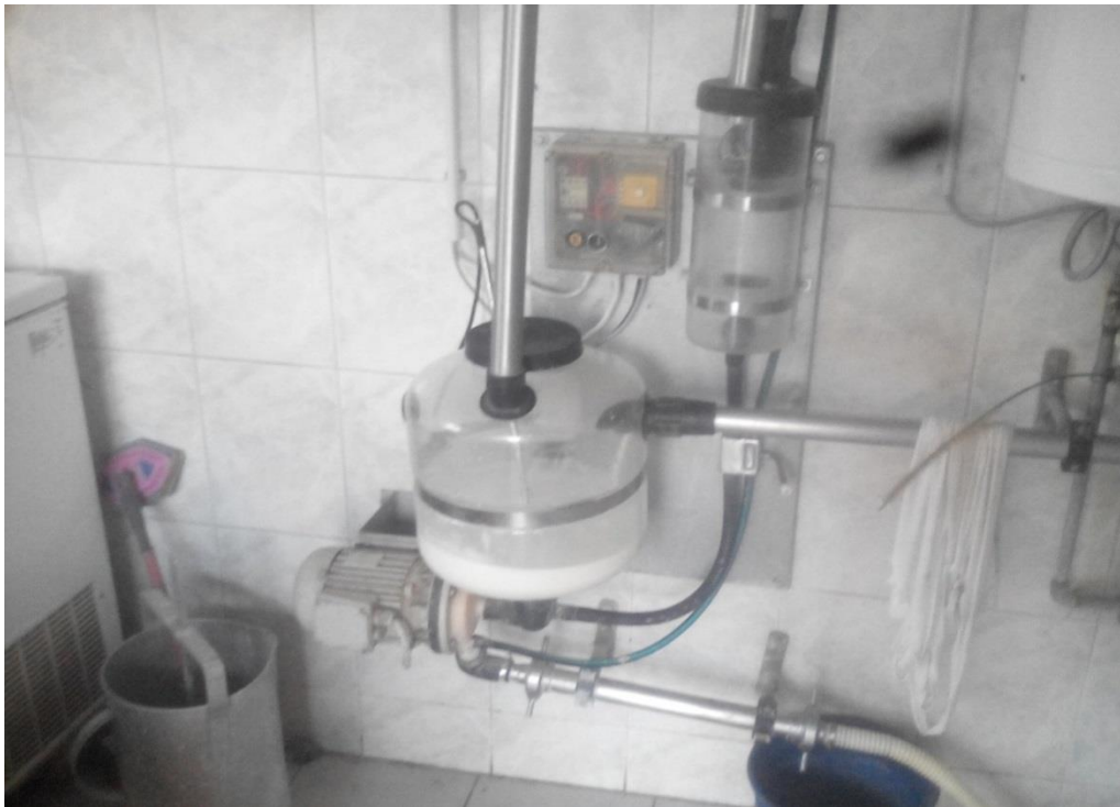
Slika 15. Prihvatna komora i sanitarni lonac (Foto: Švub)
