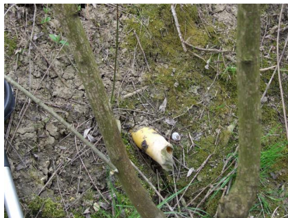
Slika 5. Oštećenje drenske cijevi spaljivanjem vegetacije (Petošić i sur., 2015)
