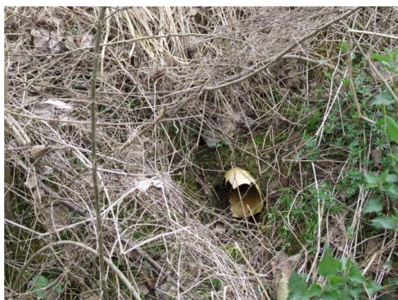
Slika 4. Oštećenje drenske cijevi prolaskom strojnih kosilica (Petošić i sur., 2015)
