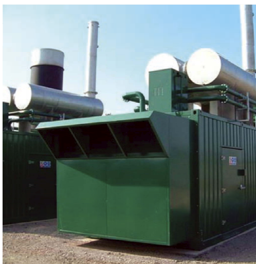
Slika 58 Kogeneracijsko postrojenje (CHP) (izvor: www.puntex.wordpress.com )
