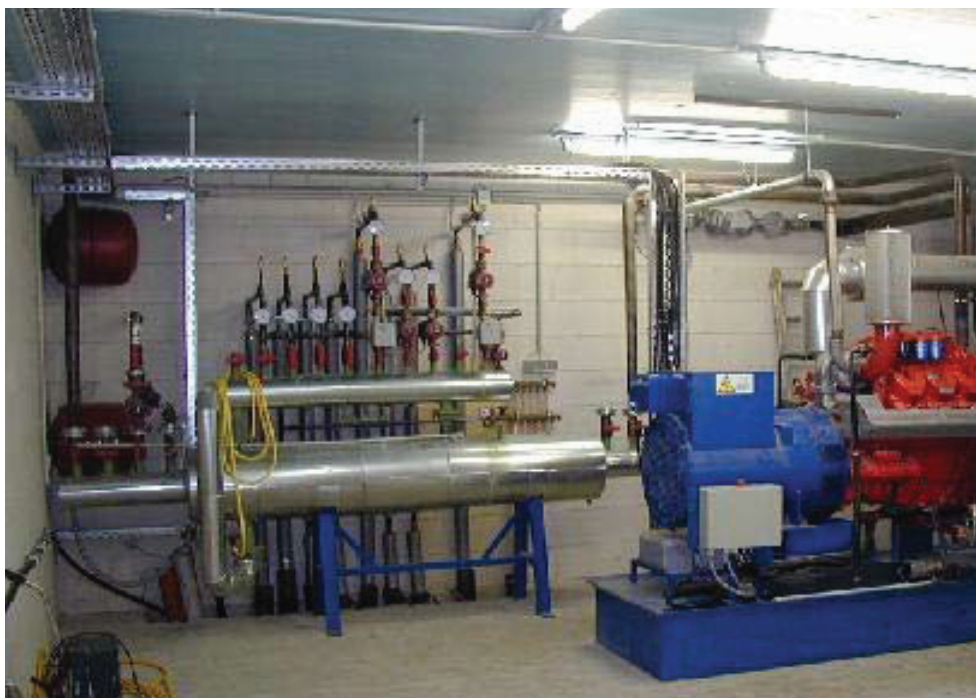
Slika 7. Detalj plinske stanice
