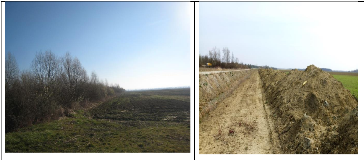
Slika 12. Neodržavana kanalska mreža na istraživanom području (lijevo) i nestručno izmuljivanje kanalske mreže sa oštećenim izljevima cijevne drenaže (desno).
