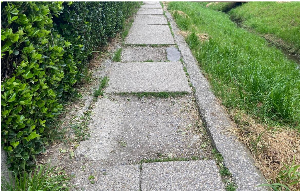
(slika 3.4.5.6 fizička oštećenja betonskih ploča, Ivan Stošić, 2023.)
