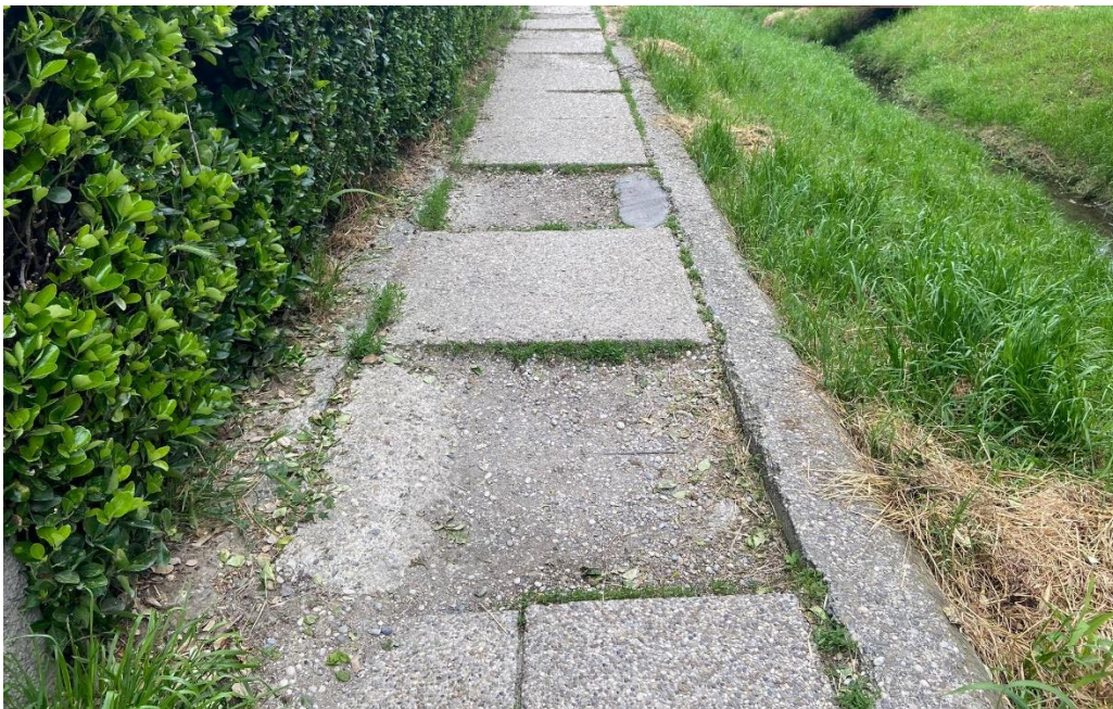
(slika 3.4.5.6 fizička oštećenja betonskih ploča, Ivan Stošić, 2023.)
