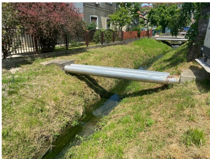
(slika 3.4.5.12 konekcija obiteljskih kuća na javnu podzemnu infrastrukturu preko potoka, Ivan Stošić, 2023.)
