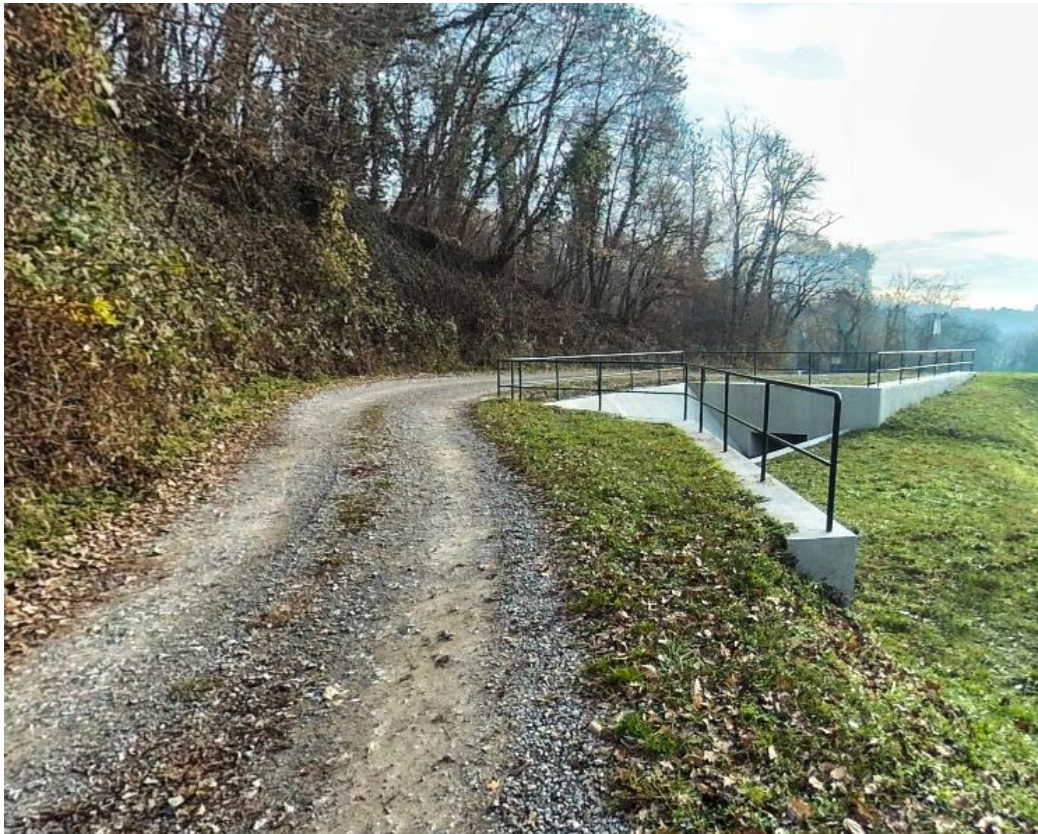
(slika 3.4.1.3 šumski servisni put i pješačka staza uz branu i retenciju 'Kustošak E'
