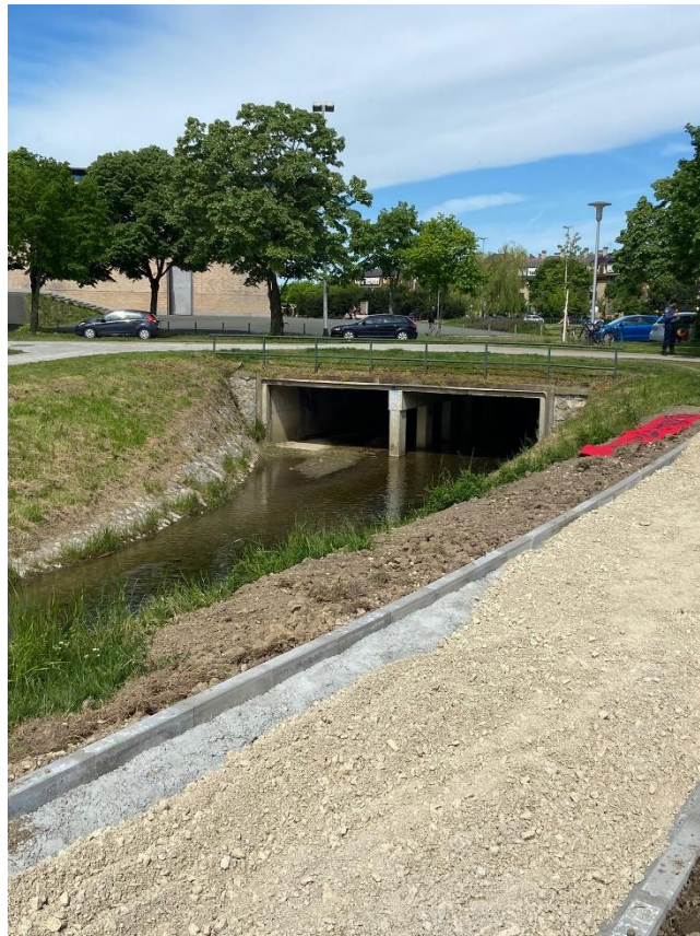
(slika 3.4.3.16 izlaz potoka iz kanal južno od Horvaćanske ceste, Ivan Stošić, 2023.)
