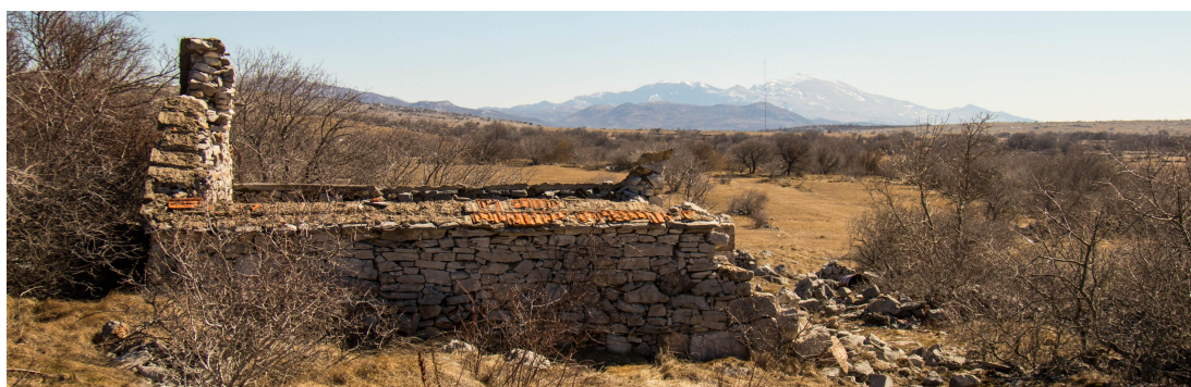
Slika 4.7.4. Urušena tradicionalna kuća.
