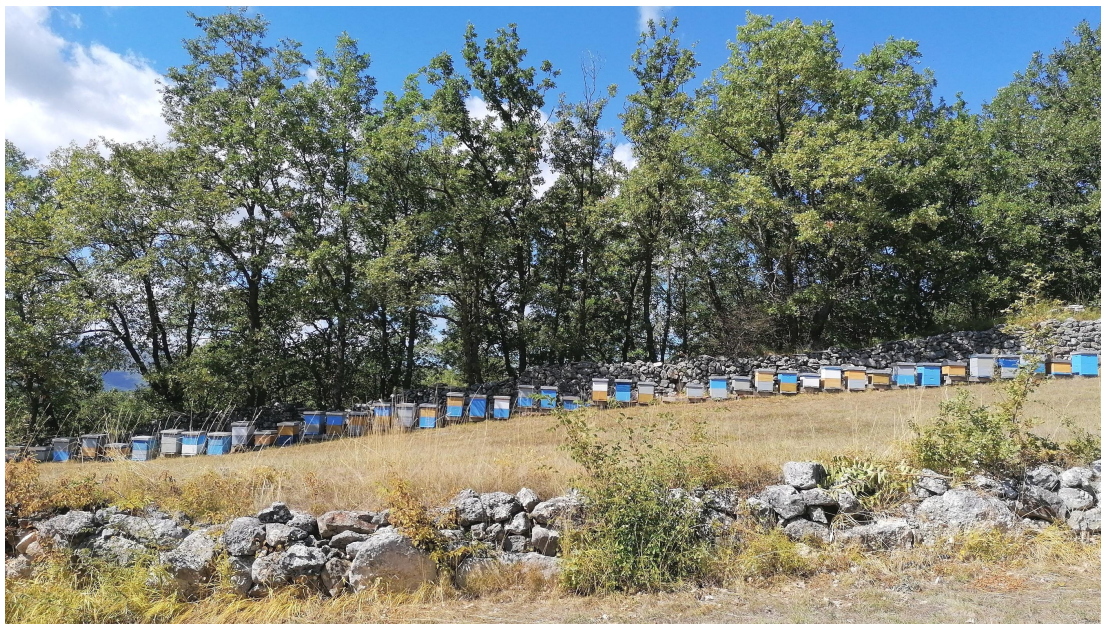
Slika 4.7.3. Djelomično urušena suhozidna gradnja.
