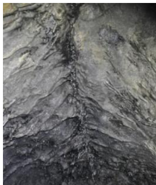
Slika 6.2.1.12.: Pukotina sa sigama na stropu
