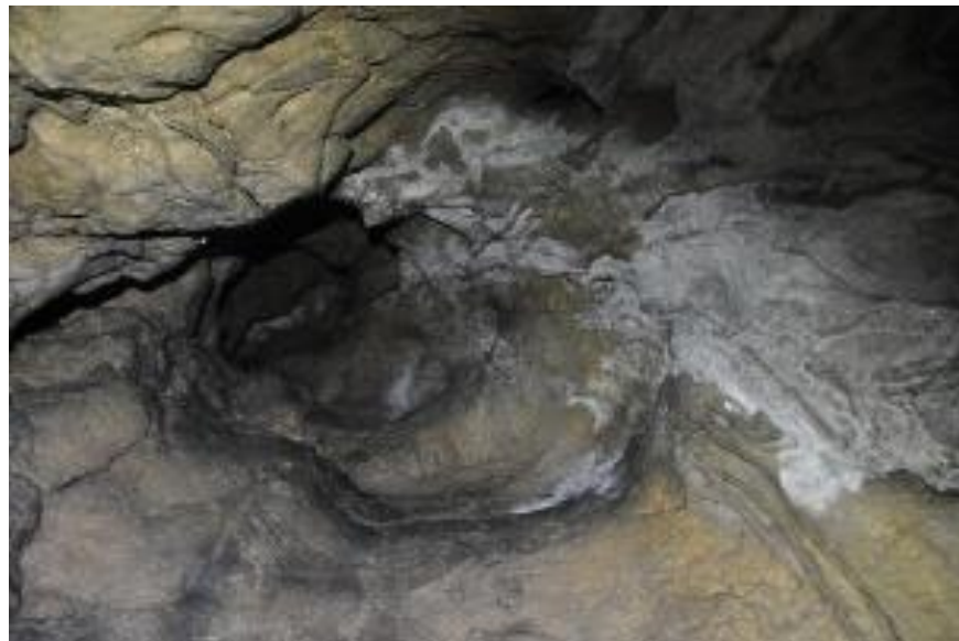
Slika 6.2.2.8.: Udubina u stropu ispunjena čađom
