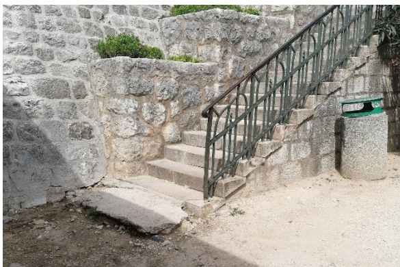
Slika 3.2.5.7. Park Pile – oštećene stepenice
