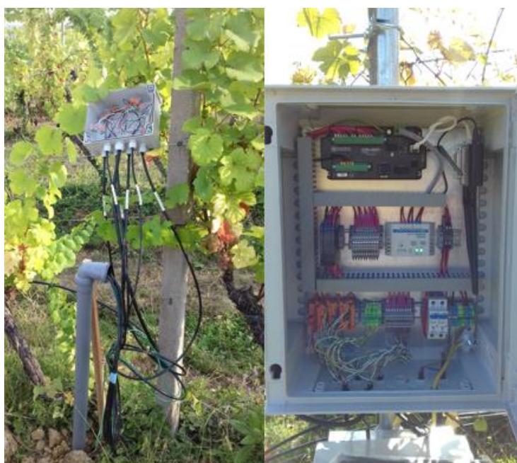
Slika 3.8. Razvodna kutija (lijevo) i centralna bazna stanica sa dataloggerom (desno)
