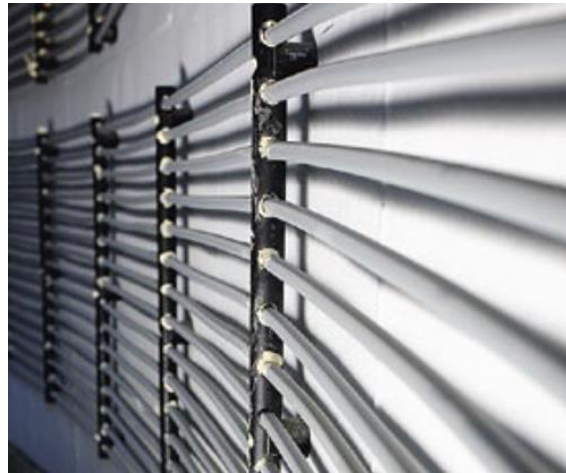
Slika 22. Toplovodne cijevi u digestoru (Martinov M i sur. 2012)
