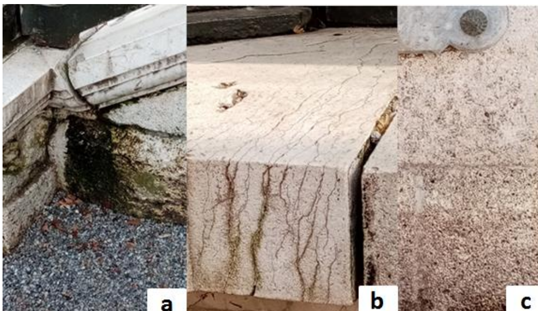
Slika 3.2.5.1. Oštećenja Glazbenog paviljona: a) biološka kolonizacija algama; b) puknuća; c) prirodno stanje arhitektonskog kamena.
