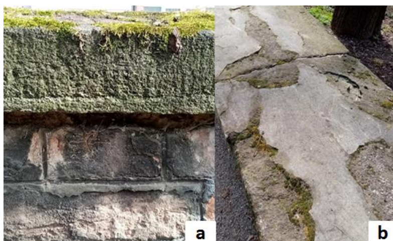
Slika 3.3.3.2. Istočna ograda: a) biološka kolonizacija algama i mahovinama, diferencijalno trošenje, pojava tafona, crna kora i prljanje; b) površinsko odvajanje, delaminacija i prsnuće.
