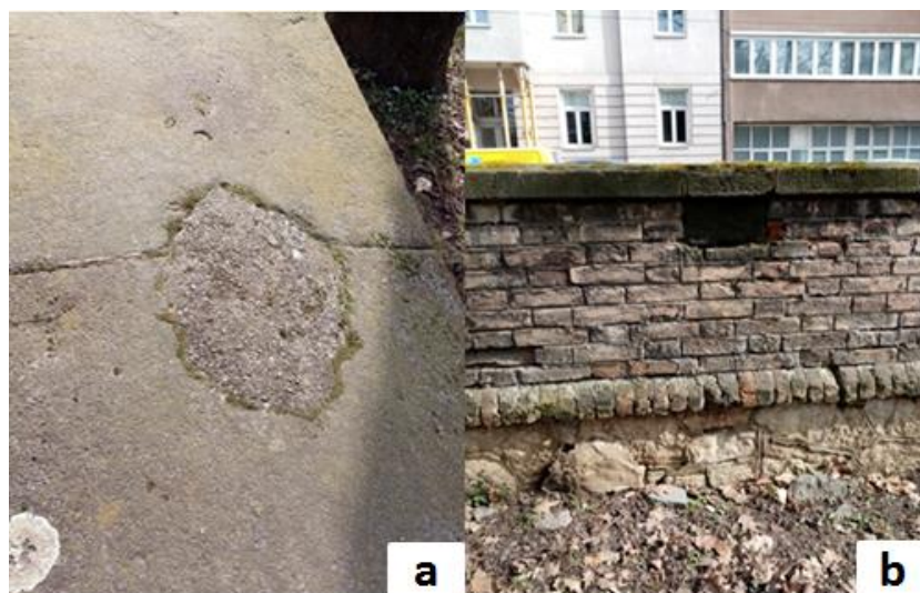
Slika 3.3.3.1. Oštećenja ograde: a) biološka kolonizacija lišajeva i mahovine; b) izostanak segmenata ograde.
