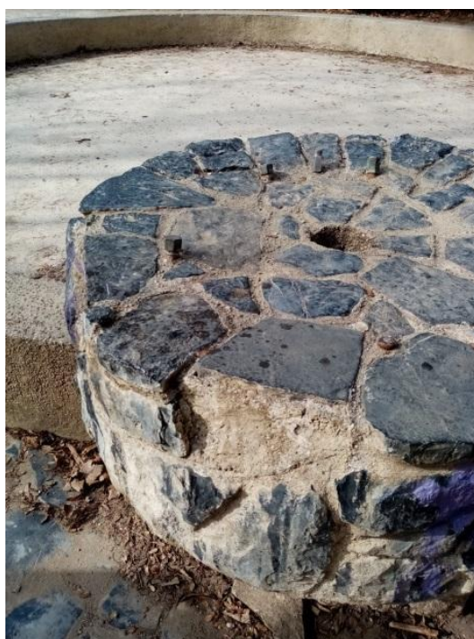
Slika 3.3.5.1. Fontana (Ribnjak), oštećenja u vidu promjene obojenja (prljanje i grafiti), oštećenja nastala mehaničkim djelovanjem, te vidljivi nedostatak segmenta fontane.
