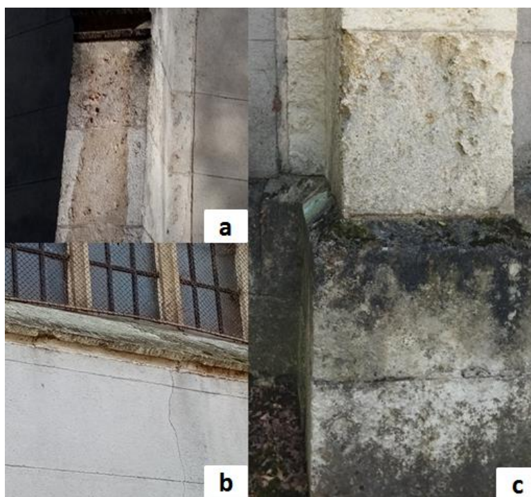
Slika 3.1.12.1. Oštećenja na kapelici sv. Jurja: a) taloženje; b) prljanje, puknuća; C) prljanje, granularno osipavanje i odvajanje.
