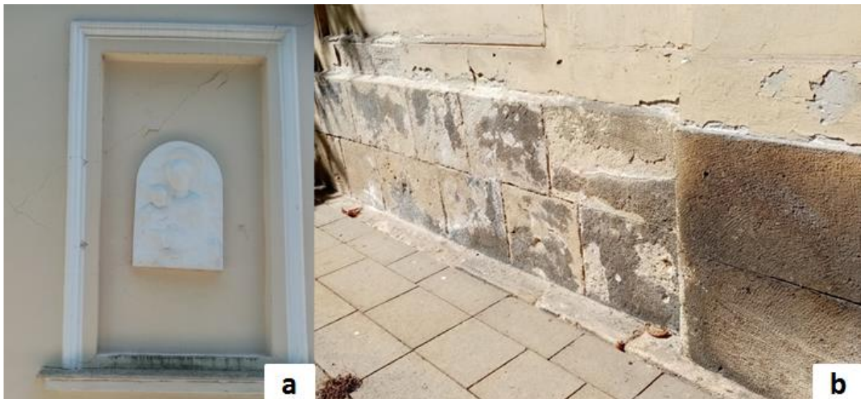
Slika 3.1.16.1 Oštećenja zatečena na pomoćnim objektima (istočni dio Maksimira):
