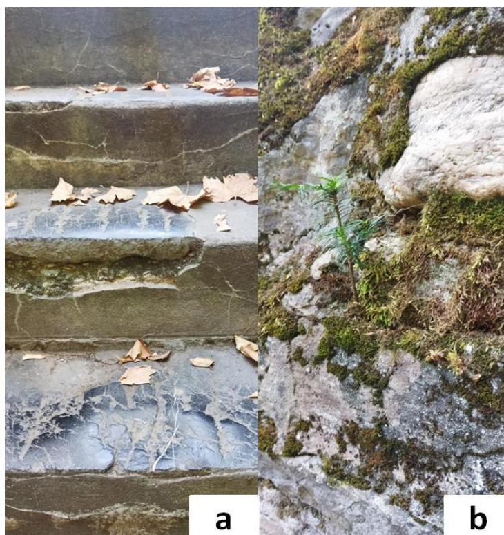
Slika 3.1.8.1. Oštećenja zatečena na Kuli: a) izlizana površina gazišta, odlamanje; b) biološka kolonizacija biljem i mahovinama.
