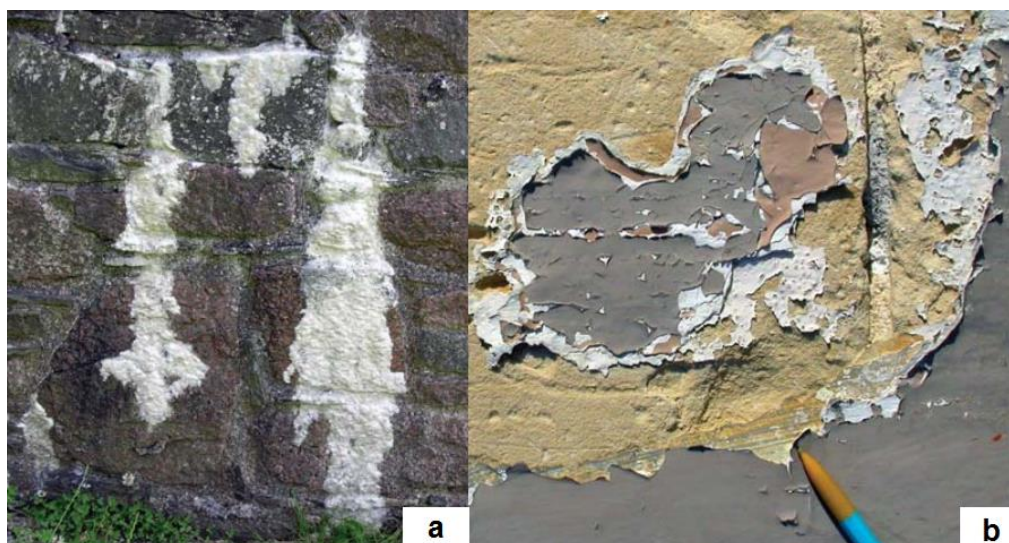
Slika 2.2.19. Tipovi oštećenja promjene boja i taloženja a) pojava naslage minerala - inkrustacije, b) film koji se ljušti Izvor: Vergès-Belmin, 2008.
