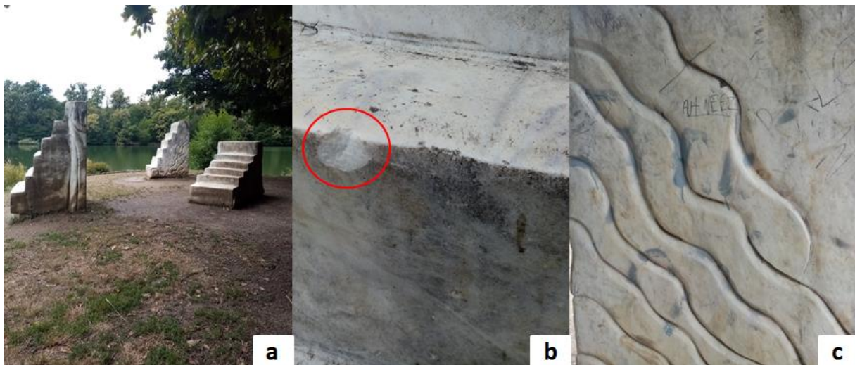
Slika 3.1.13.1. Oštećenja zatečena na Stepenicama: a) prikaz stepenica; b) prsnuće; c) prljanje i grafiti.
