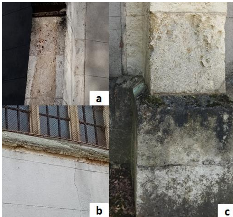
Slika 3.1.12.1. Oštećenja na kapelici sv. Jurja: a) taloženje; b) prljanje, puknuća; C) prljanje, granularno osipavanje i odvajanje.
