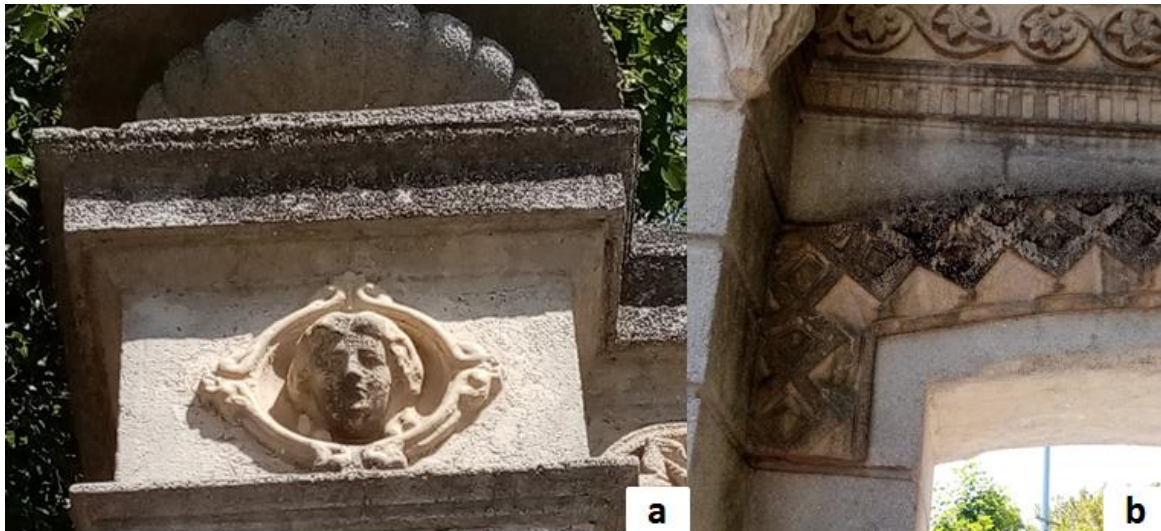
Slika 3.1.1.2. Oštećenja na ulaznim vratima: a) crna kora, granularna dezintegracija; b) alge, prljanje i crna kora
