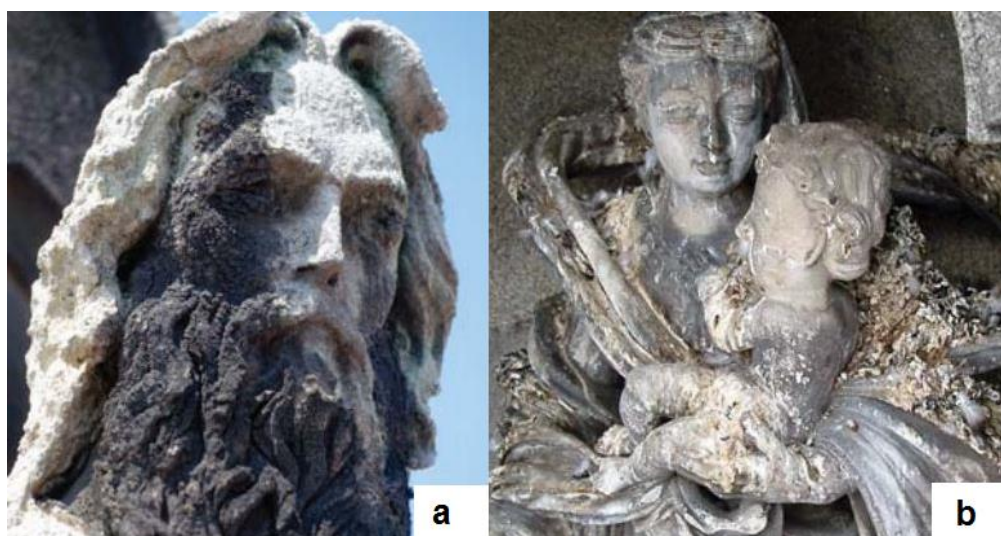
Slika 2.2.17. Tipovi oštećenja promjene boja i taloženja a) pojava crne kore na kipu, b) naslaga (ptičji izmet) Izvor: Vergès-Belmin, 2008.
