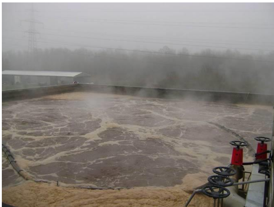
Slika 2.11. Biološki pročišćivač otpadnih voda (engl. Sequencing batch reactor)
