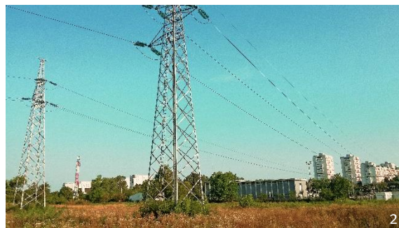
SLIKA 32: Pogled na dalekovod i trafostanicu (2018.)
