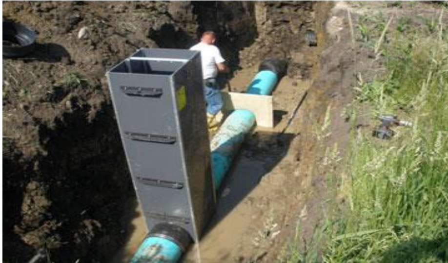
Slika 10. Kontrolna građevina Izvor: https://brownfieldagnews.com
