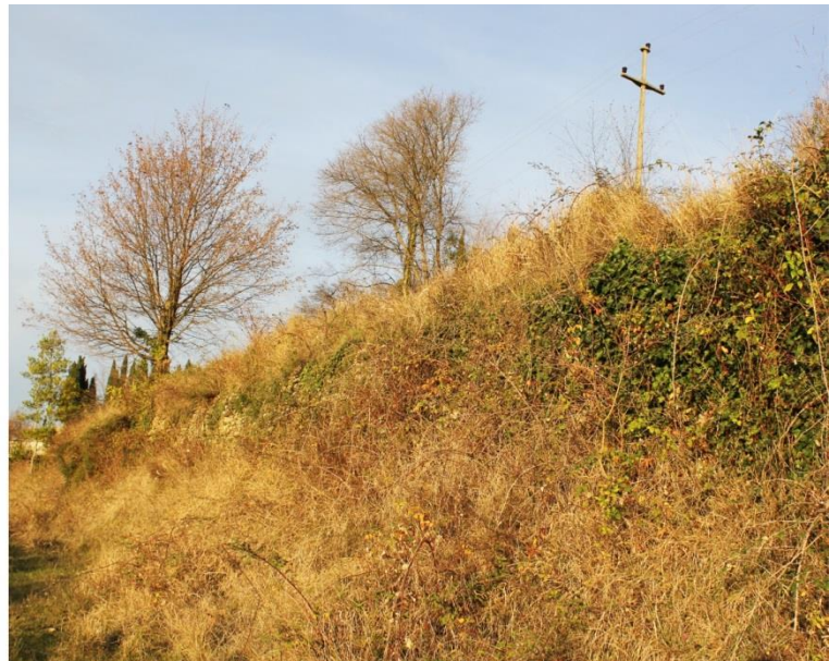
Slika 4.9. Suhozid dug više od 10 m skoro je u cijelosti prekriven nanosima sedimenta i obrastao vegetacijom
