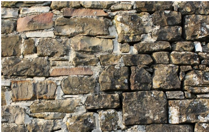
Slika 4.10. Dio zidina koji je „obnovljen“ betonom
