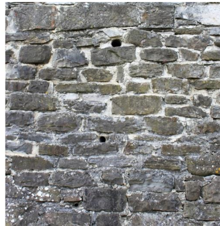
Slika 4.11. Cijevi za odvod vode
