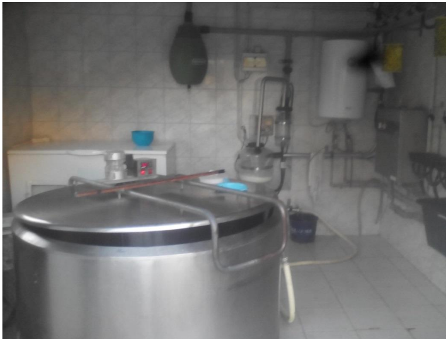
Slika 12. Laktofriz i mljekovod (Foto: Švub)
