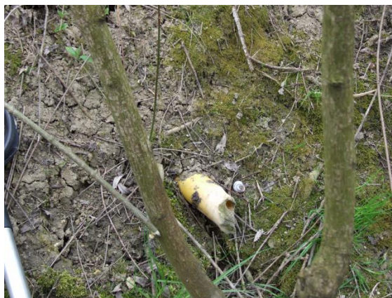
Slika 5. Oštećenje drenske cijevi spaljivanjem vegetacije (Petošić i sur., 2015)
