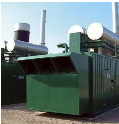
Slika 58 Kogeneracijsko postrojenje (CHP) (izvor: www.puntex.wordpress.com )
