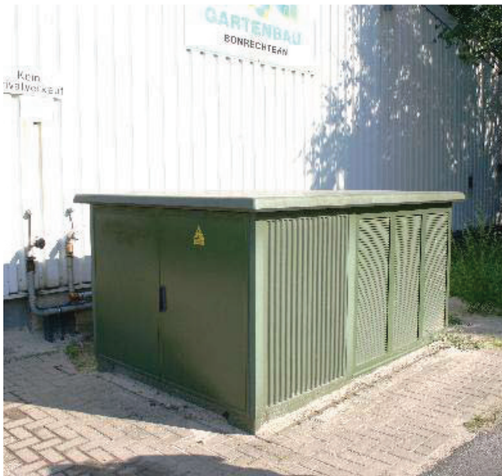
Slika 14. Priključak bioplinskog postrojenja na elektroenergetsku mrežu
