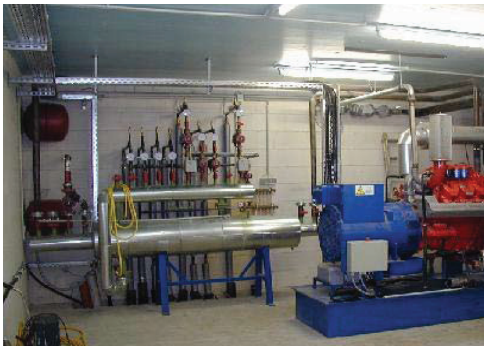
Slika 7. Detalj plinske stanice
