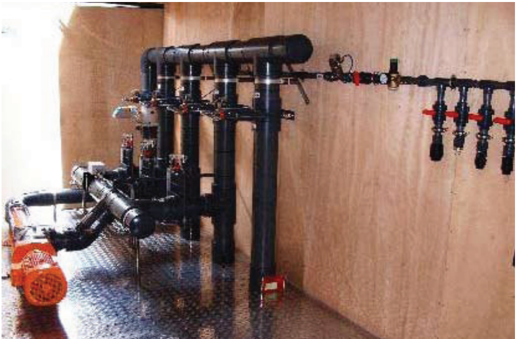
Slika 9. Detalj plinske stanice
