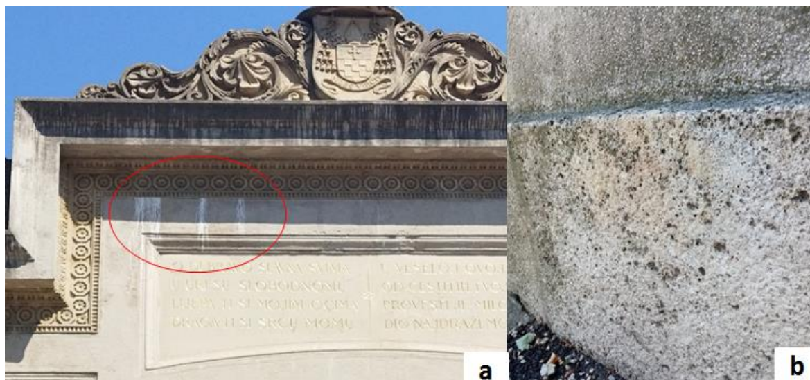
Slika 3.1.1.1. Oštećenja na ulaznim vratima: a) crna kora, inkrustacija i tragovi prljanja; b) tragovi prljanja, alge
