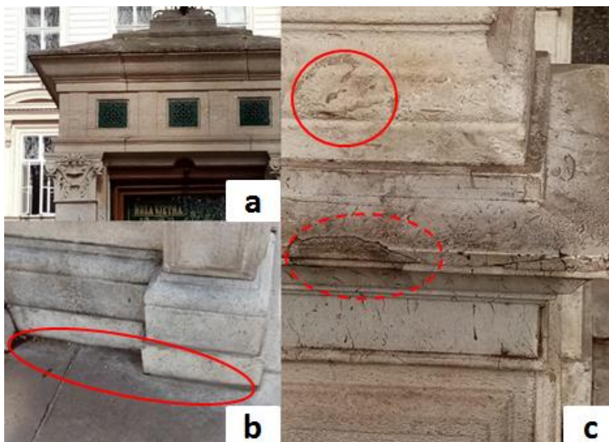
Slika 3.2.4.1. Meteorološki stup: a) alge; b) mrljanje od vlage i migracija soli; c) deskvamacija, puknuća.
