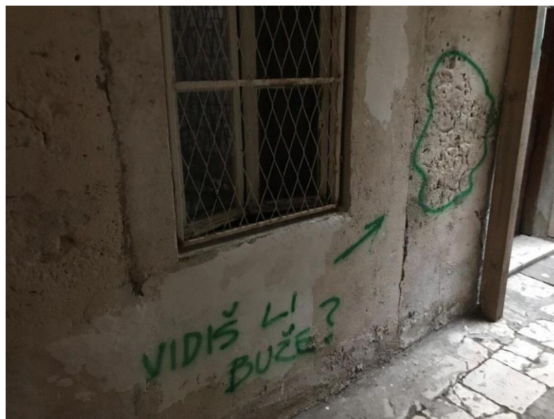
Slika 2.2.20. Tip oštećenja promjene boje- grafit na fasadi objekta i kameno opločenje koje je zbog izlizanosti postalo sjajno GRAD SPLIT TRPI NERED, ALI NE I GRAĐANSKI NEPOS LUH? https://www. Dalmacijadanas. hr/grad-split-trpi-nered-ali-ne-i-gradanski-neposluh-ilegalna-gradnja-grafiti-plakati-zvake-moze-mural-splitskoj-sportskoj-legendi-ne-moze/ -Pristup 15. 08. 2021.
