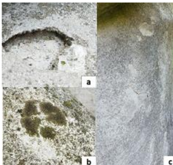
Slika 3.1.11.2. Oštećenja na Egipćanima: a) prsnuće; b) biološka kolonizacija mahovinama i algama; c) površinsko ljuštenje.
