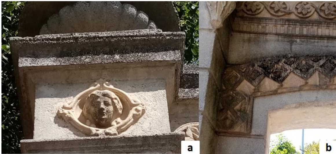
Slika 3.1.1.2. Oštećenja na ulaznim vratima: a) crna kora, granularna dezintegracija; b) alge, prljanje i crna kora
