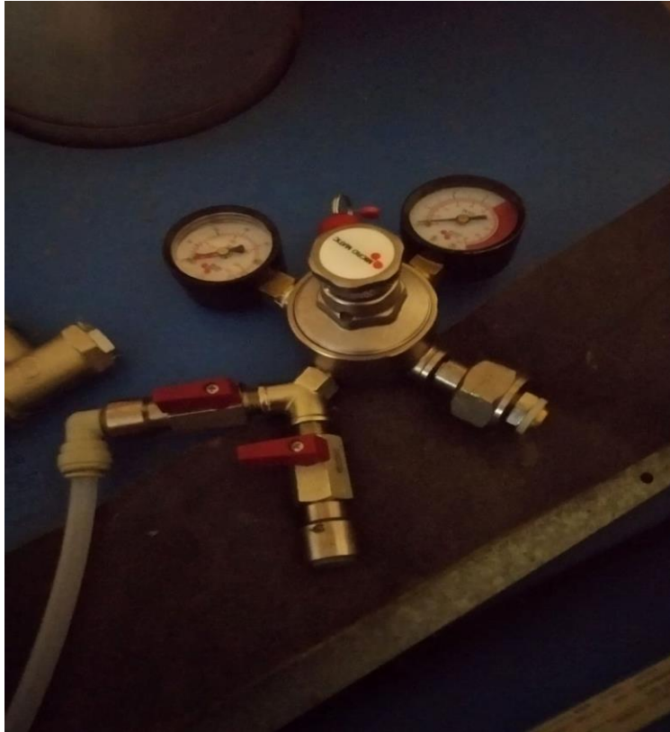
Slika 9. Priključak za unos inertnog plina (5. 10. 2019.)
