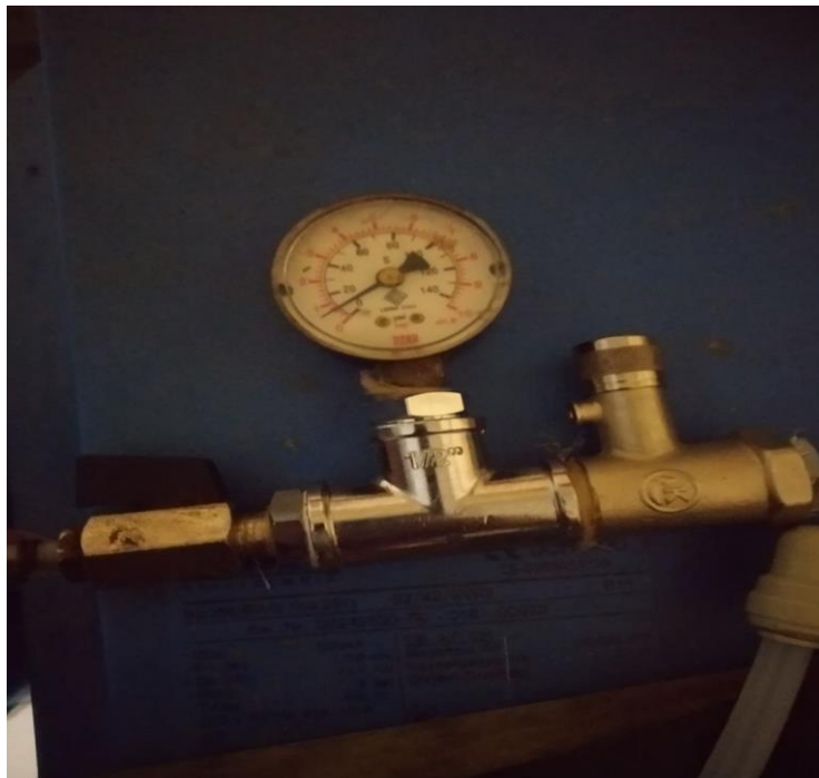
Slika 10. Priključak za ispust tlakova sa sigurnosnim ventilom (5. 10. 2019.)
