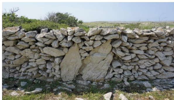
Slika 116. Jednostruki suhozid s velikim stijenama u podnožju koji ograđuje nekadašnju njivu, a sada pašnjak u katastarskoj općini Poveljana
