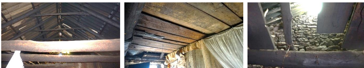
Slika 295., 296., 297. Krovište kuće koje nije autentično, a obzirom da se ta obitelj bavila puno duže ovim poslom od kazivača, u međuvremenu su postavili i azbestni krov
