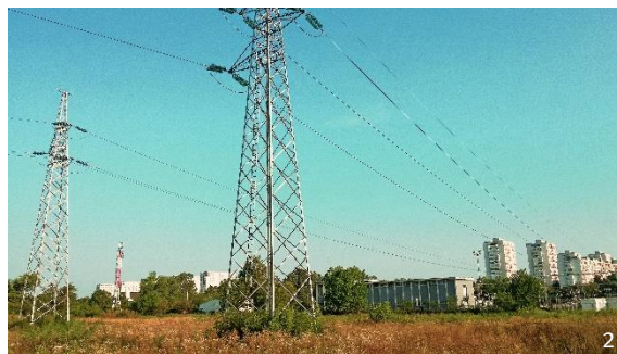
SLIKA 32: Pogled na dalekovod i trafostanicu (2018.)
