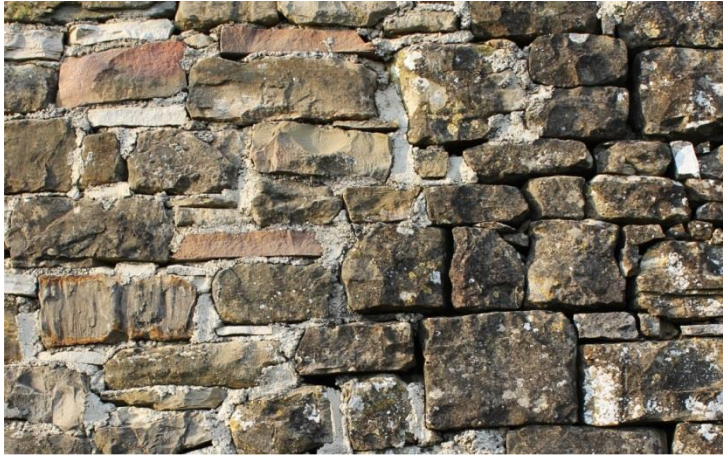
Slika 4.10. Dio zidina koji je „obnovljen“ betonom
