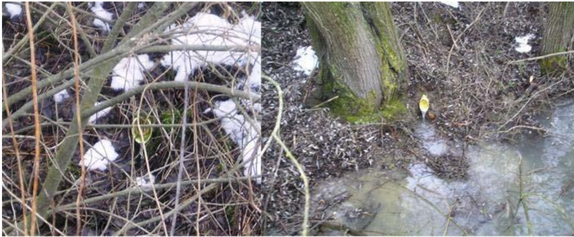
Slika 20. Prikaz lošeg održavanja hidromelioracijskih sustava detaljne odvodnje
