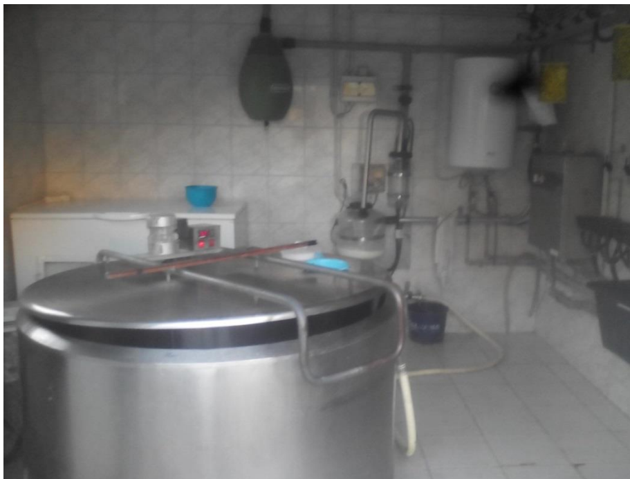
Slika 12. Laktofriz i mljekovod (Foto: Švub)
