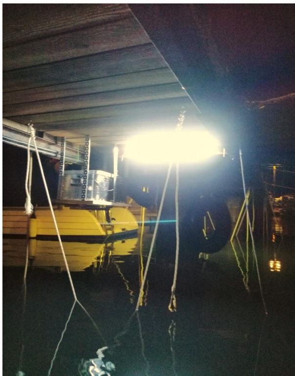
Slika 3.4.2. LED svjetlo postavljeno iznad predviđenog mjesta za kolektore.
