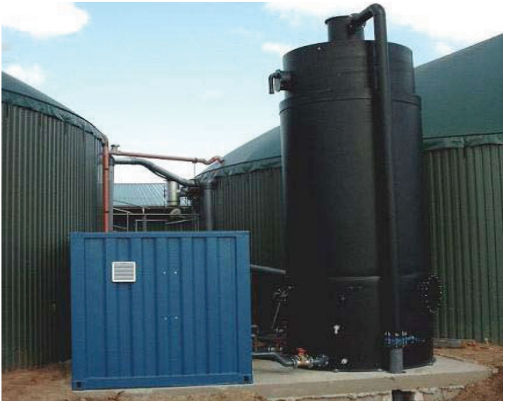
Slika 16. Detalj bioplinskog postrojenja
