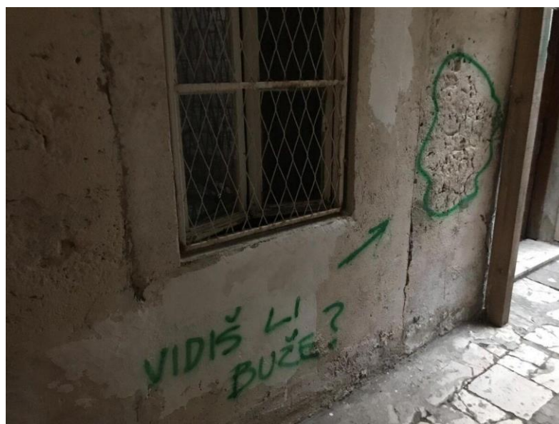
Slika 2.2.20. Tip oštećenja promjene boje- grafit na fasadi objekta i kameno opločenje koje je zbog izlizanosti postalo sjajno GRAD SPLIT TRPI NERED, ALI NE I GRAĐANSKI NEPOSLOH? https://www. Dalmacijadanas. hr/grad-split-trpi-nered-ali-ne-i-gradanski-neposluh-ilegalna-gradnja-grafiti-plakati-zvake-moze-mural-splitskoj-sportskoj-legendi-ne-moze/ -Pristup 15. 08. 2021.
