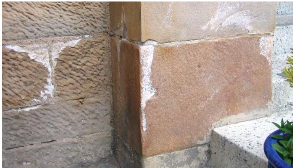
Slika 2.2.22. Tipovi oštećenja promjene boja i taloženja - gubitak površinskog sloja arhitektonskog kamena uzrokovan subflorescencijom Izvor: Vergès-Belmin, 2008.
