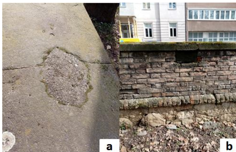
Slika 3.3.3.1. Oštećenja ograde: a) biološka kolonizacija lišajeva i mahovine; b) izostanak segmenata ograde.
