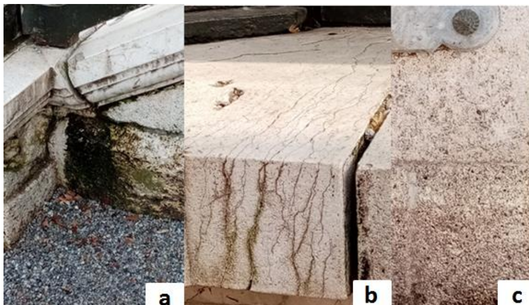
Slika 3.2.5.1. Oštećenja Glazbenog paviljona: a) biološka kolonizacija algama; b) puknuća; c) prirodno stanje arhitektonskog kamena.
