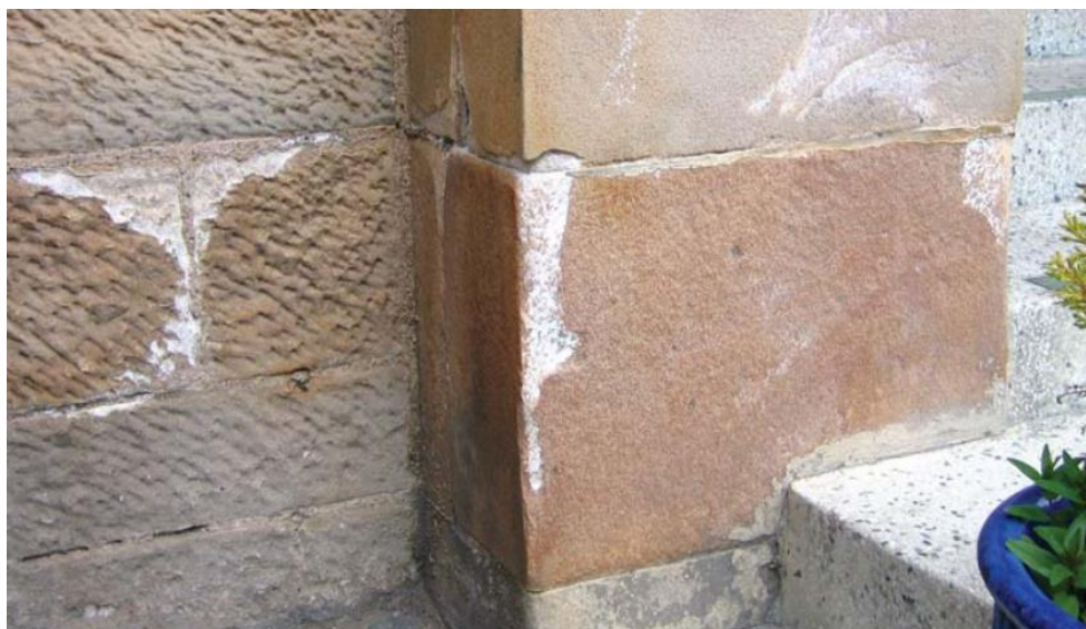
Slika 2.2.22. Tipovi oštećenja promjene boja i taloženja - gubitak površinskog sloja arhitektonskog kamena uzrokovan subflorescencijom Izvor: Vergès-Belmin, 2008.
