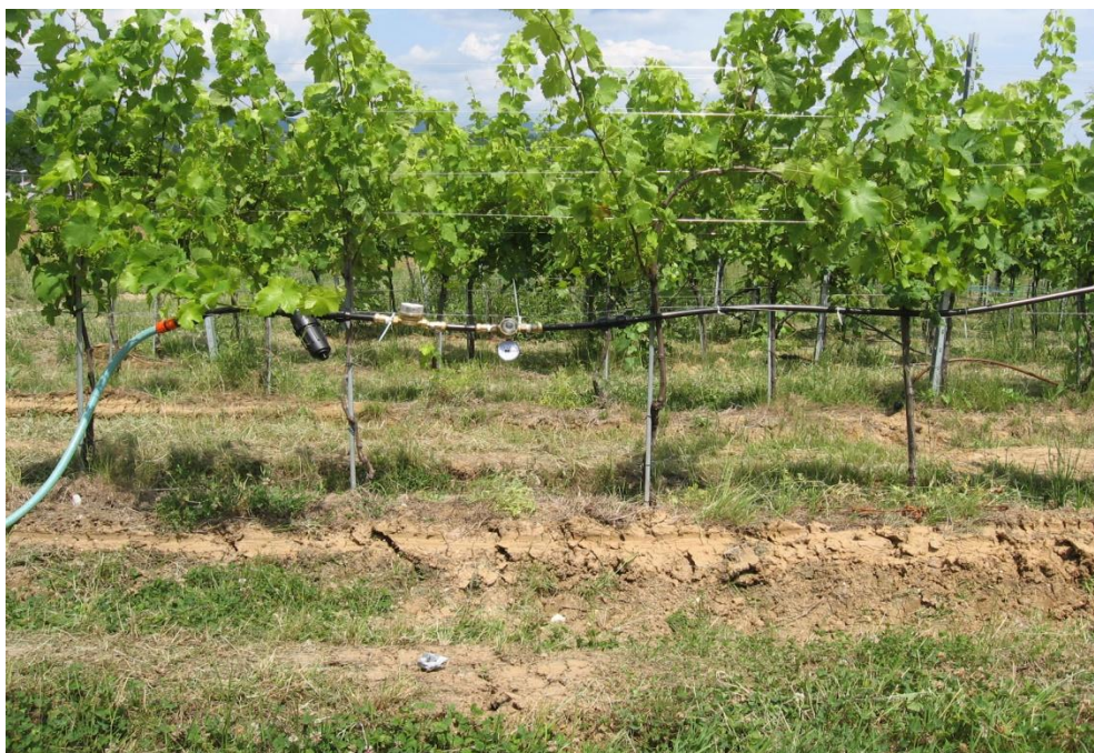
Slika 3. Dijelovi sustava kapanja; filter, regulator tlaka sa manometrom, vodomjer i laterali
