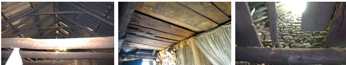
Slika 295., 296., 297. Krovište kuće koje nije autentično, a obzirom da se ta obitelj bavila puno duže ovim poslom od kazivača, u međuvremenu su postavili i azbestni krov
